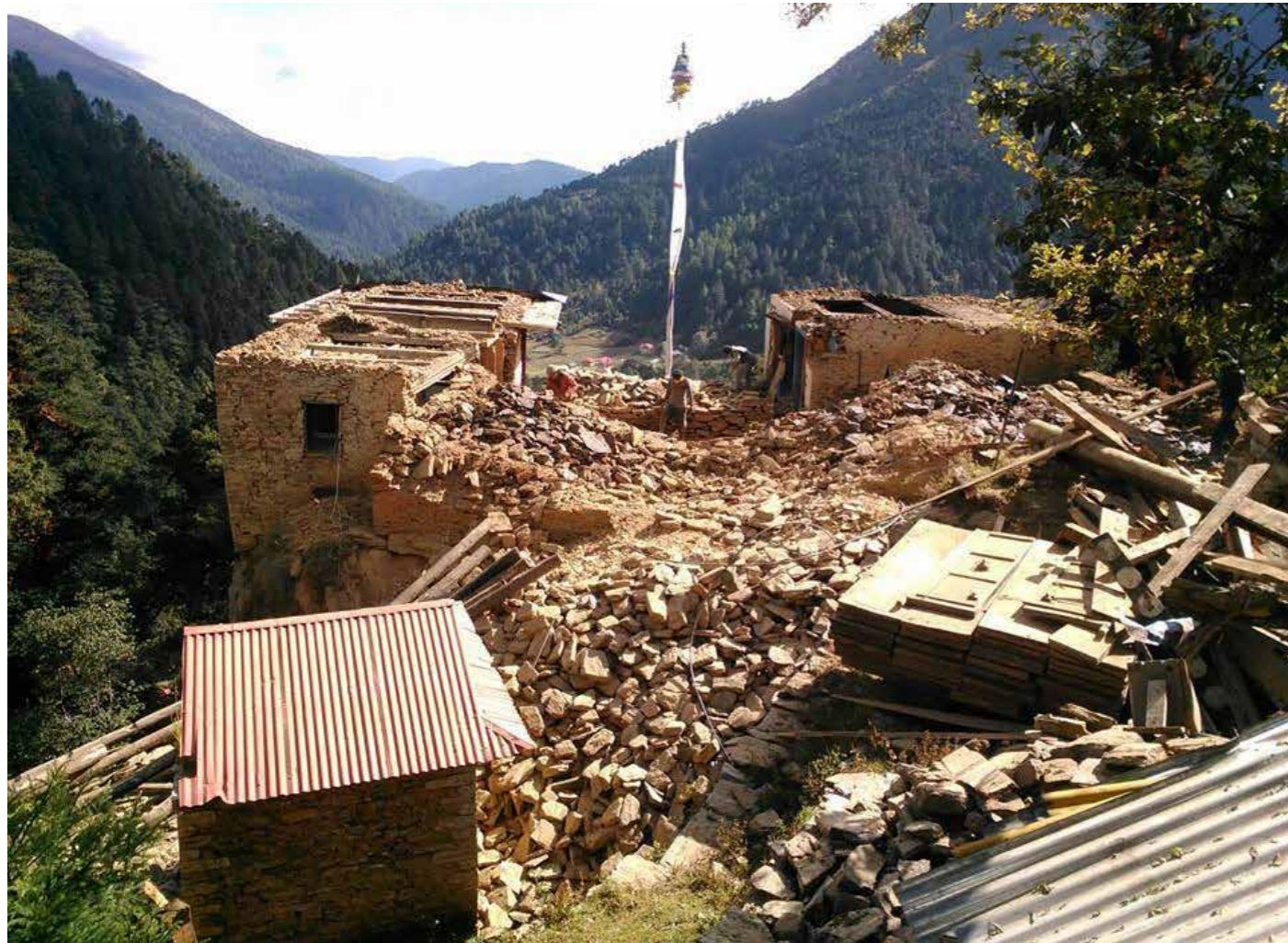
La destrucción tras el sismo de 2015 fue completa
